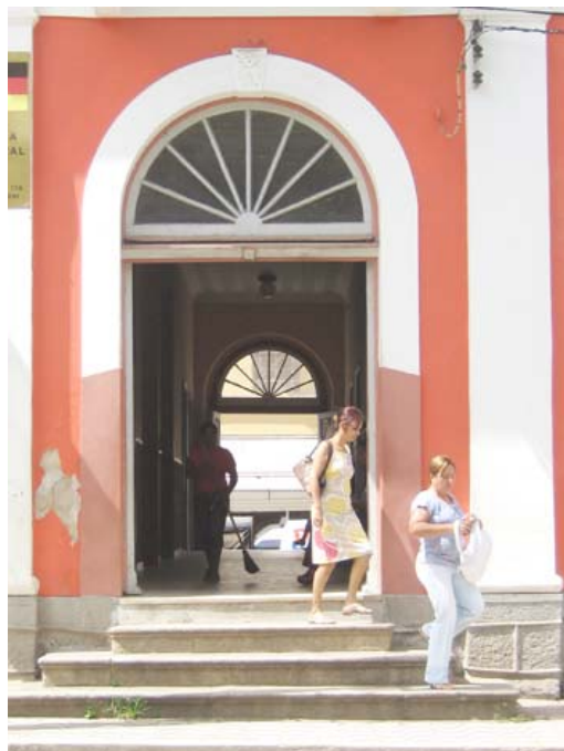
Foto10: Praça Tiradentes - Vista do acesso ao edifício da Câmara Municipal pela rua Engenheiro Antunes. Apresenta descascamento da pintura da fachada na região próxima da porta. Teófilo Otoni. Ano:2007. Fotógrafa: Karine Guimarães Berbari
