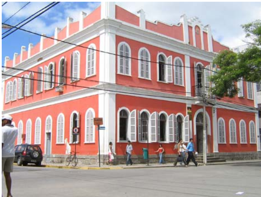
Foto09: Praça Tiradentes - Vista do edifício da Câmara Municipal à rua Engenheiro Antunes esquina com rua Dr. Reinaldo. Apresenta a fiação da iluminação pública interferindo no visual da fachada e os aparelhos de ar condicionado descaracterizantes da mesma. Há também o descascamento da fachada no lado esquerdo. Percebe-se a necessidade de pintura da faixa de travessia no asfalto. Teófilo Otoni. Ano:2007. Fotógrafa: Karine Guimarães Berbari
